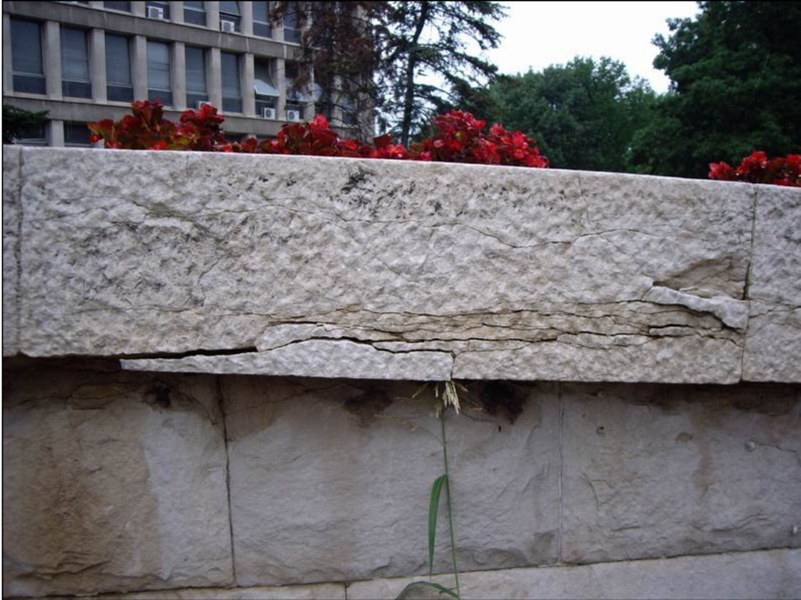
Novi Beograd, zgrada bivšeg SIV-a: oštećenja na Bračkom mermeru
