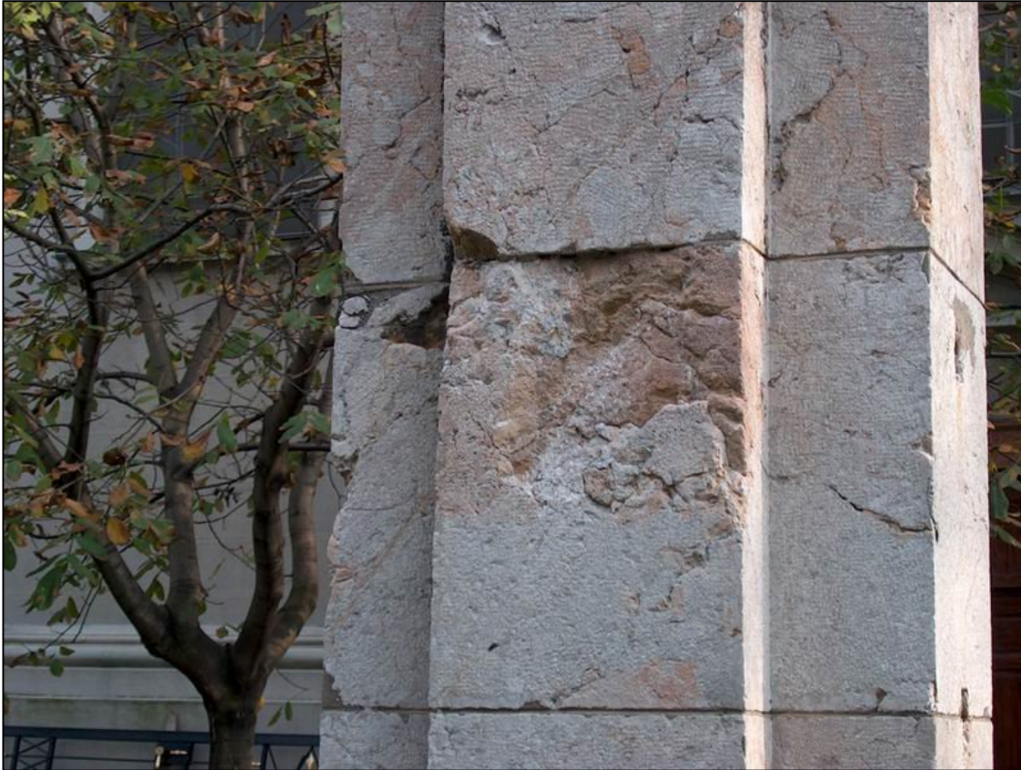
Beograd, Hram Svetog Arhangela Mihaila: oštećenja na breči nastala ispiranjem veziva (gline)
