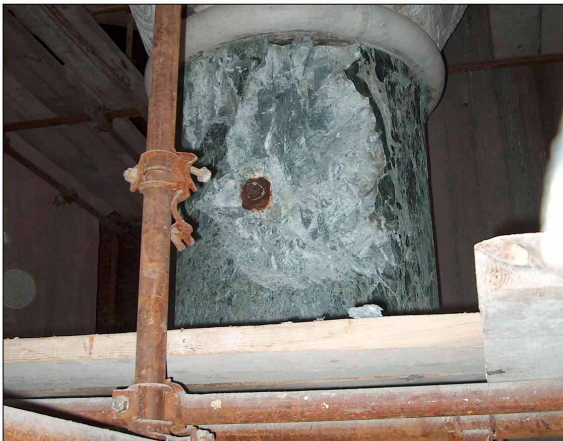
Beograd, Hram Svetog Save: oštećenja na stubu od mermera „Alpi Verde” nastala usled korodiranja gvozdenog ankera
