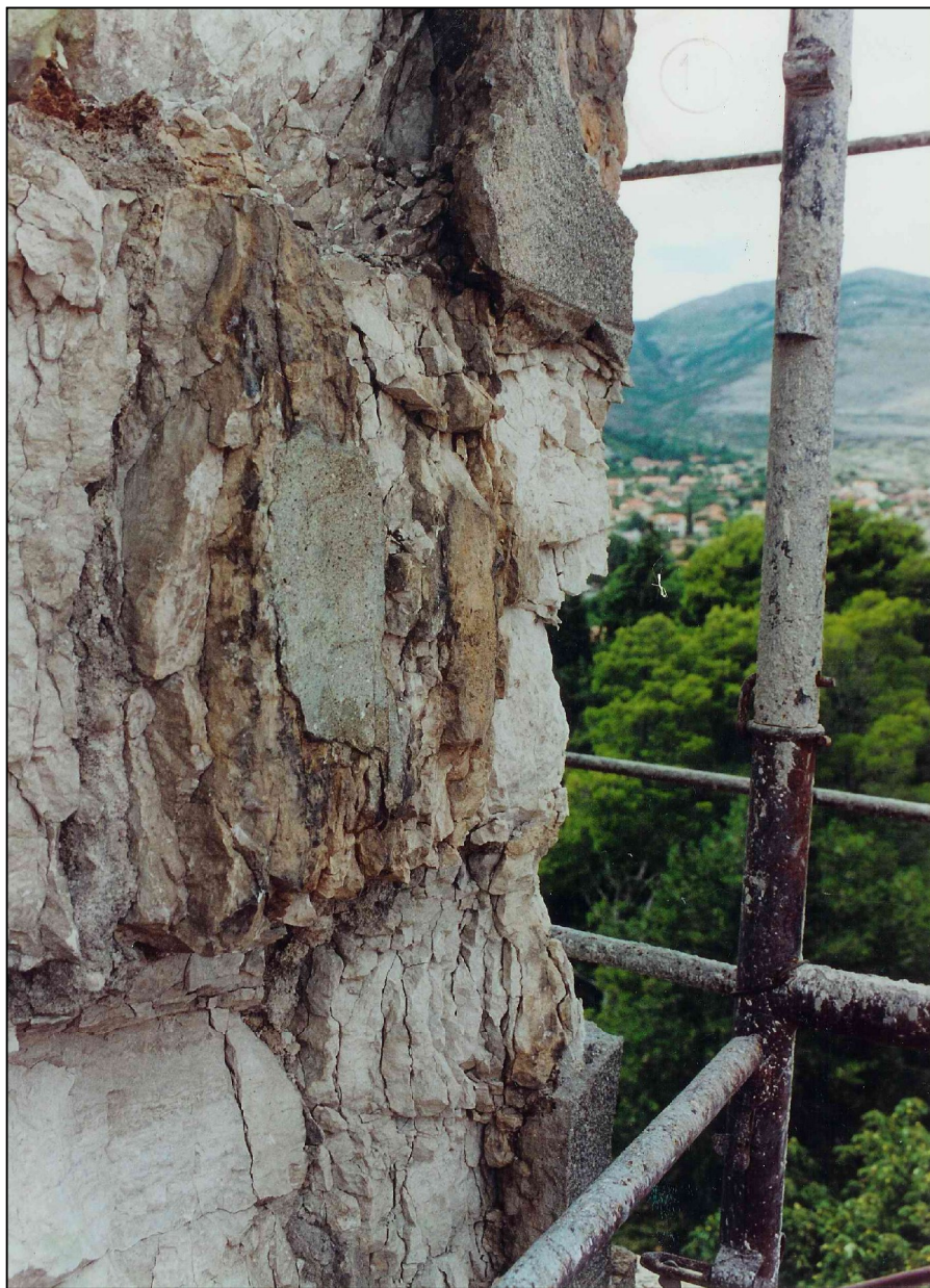
Trebinje, Hram Svetog Preobraženja Gospodnjeg: oštećenja na krečnjaku
