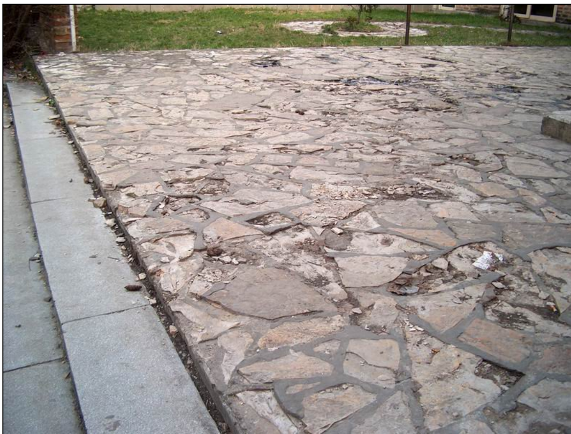
Beograd, plato ispred bioskopa Šumadija: oštećenja na Struganiku
