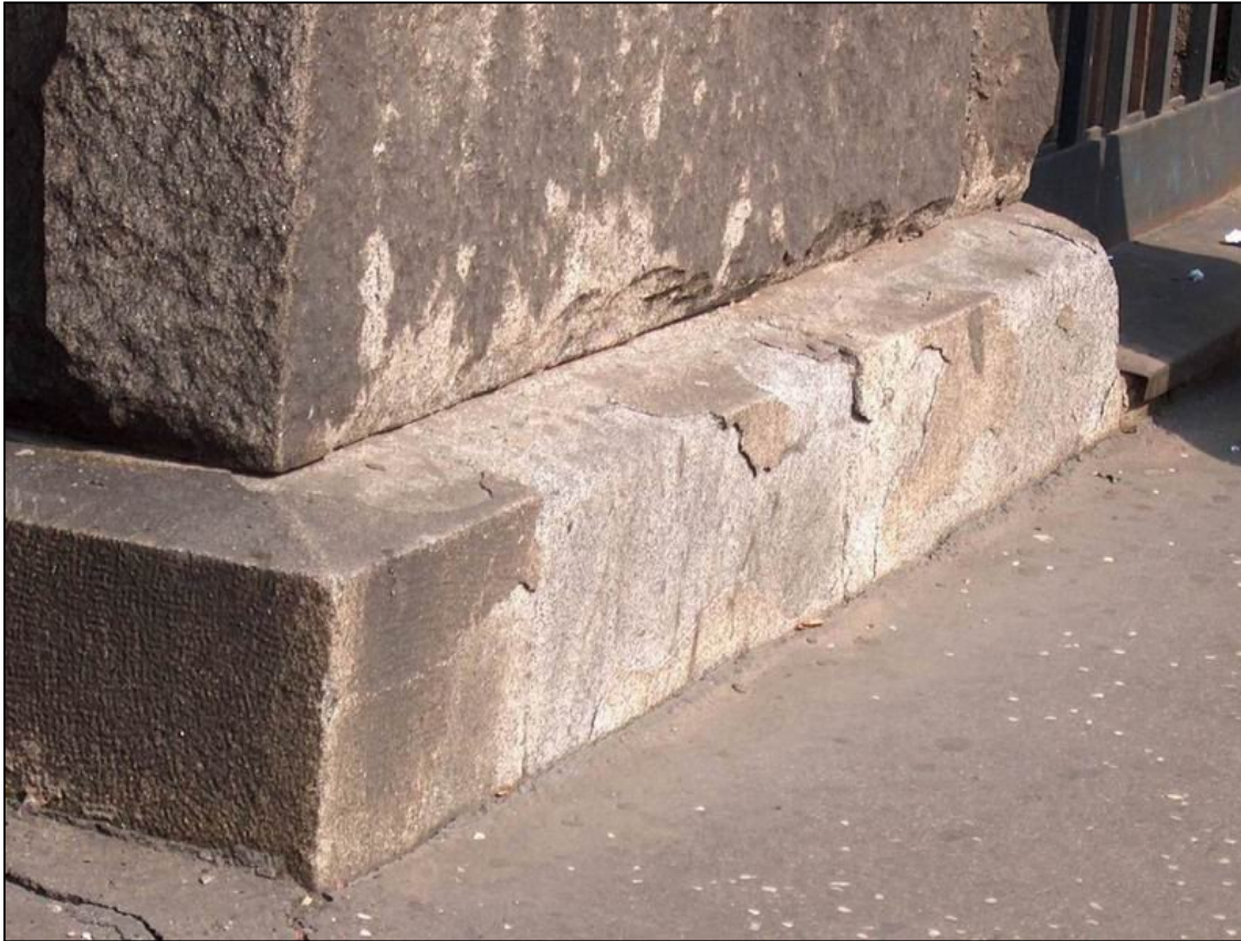
Beograd, zgrada Glavne pošte, južna fasada: oštećenja na granitu nastala dejstvom soli
